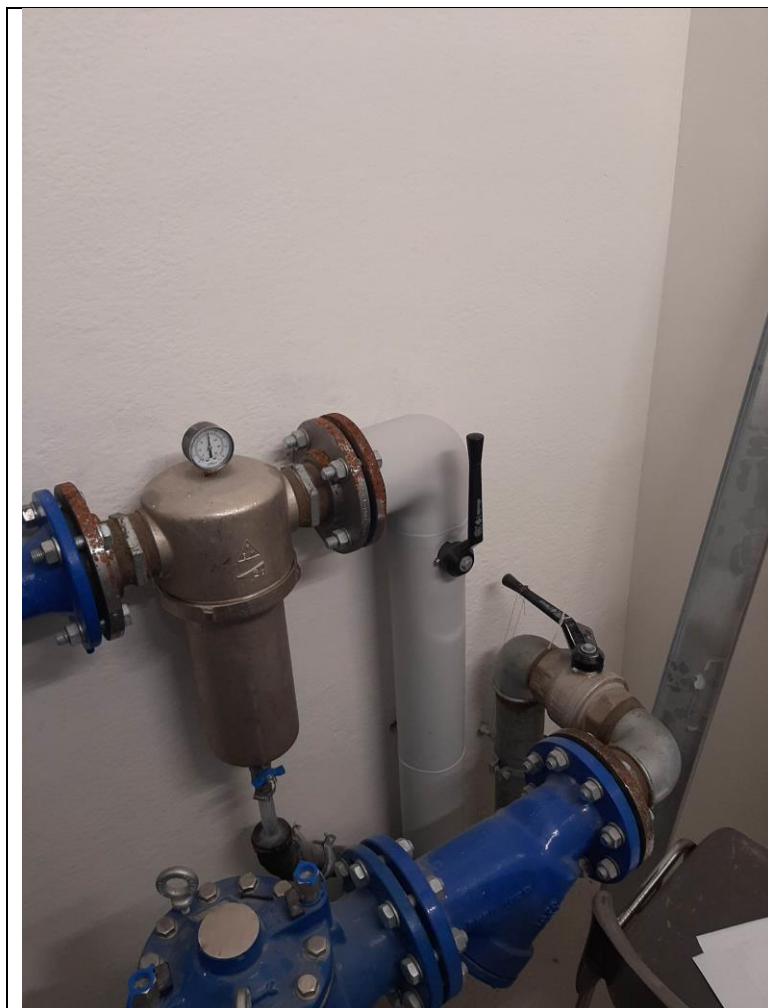
Valvole di intercettazione dell'impianto idrico del Magazzino 27
