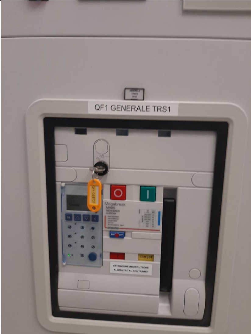
Quadro elettrico generale Magazzino 27
