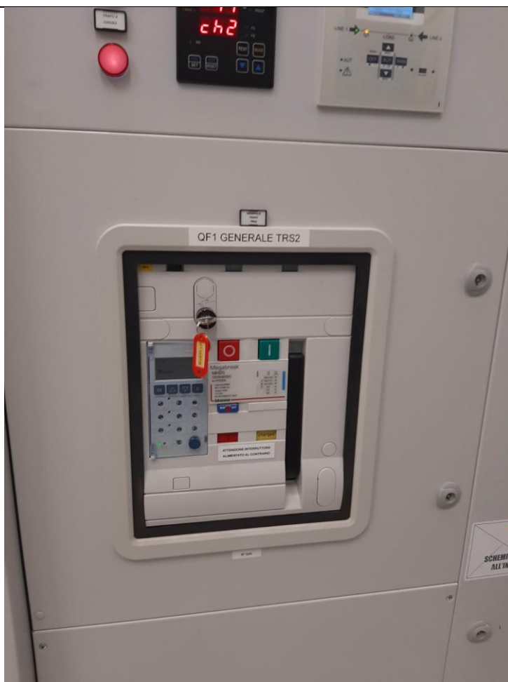
Quadro elettrico generale Magazzino 28
