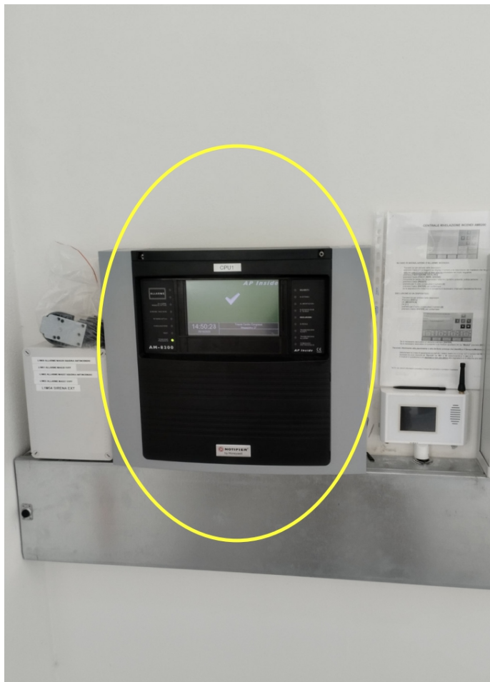
Centrale rivelazione incendi
